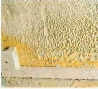
Salpêtre sur un mur humide.
